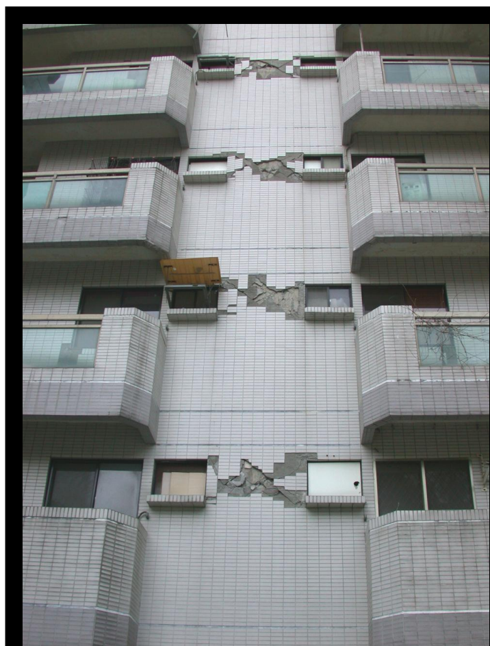
■ 危樓受震災剪力破壞情形二
