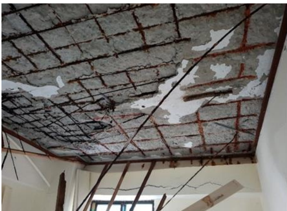
天花板水泥塊有掉落情形
