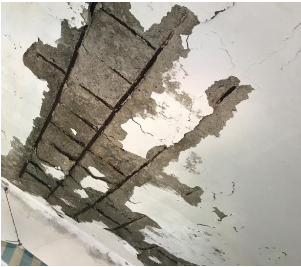
海砂中有氯離子，會加速腐蝕鋼筋，造成混凝土塊剝落
