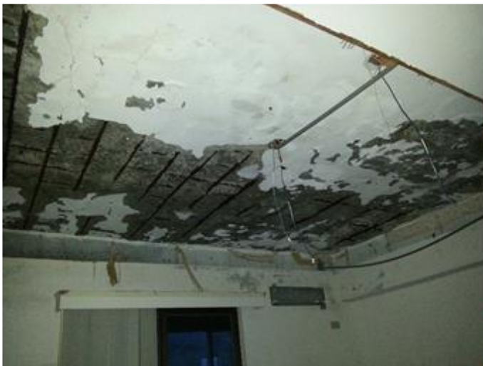
更新前建物內部天花板鋼筋裸露
