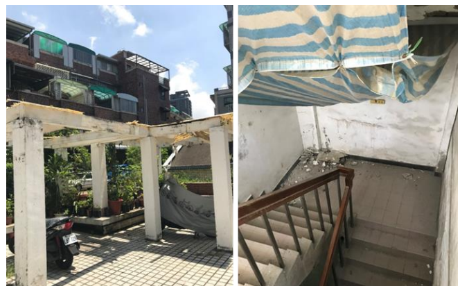
建物牆面已出現壁癌、龜裂甚至大面積剝落情形
