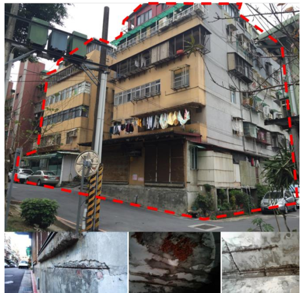
更新前建物現況建物傾斜、牆壁剝落、鋼筋外露
