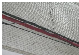
外牆立面龜裂
