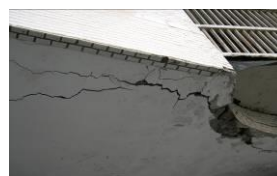
外牆鋼筋外露
