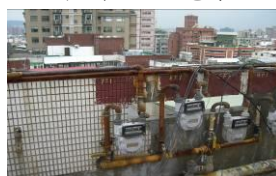
屋頂瓦斯表及管線
