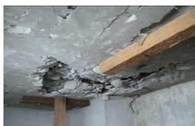
天花板鋼筋外露
