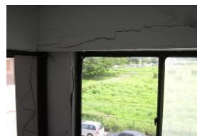
梯廳樑柱龜裂
