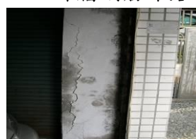
地下室柱爆裂
